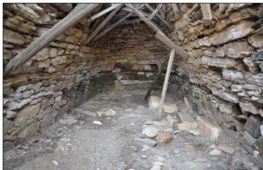
Φωτ. 13: Θολωτός τάφος IV. Πριν την τοποθέτηση μεταλλικού κριώματος αντιστήριξης. [ Αρχείο ΔΑΑΜ 2009 ]
