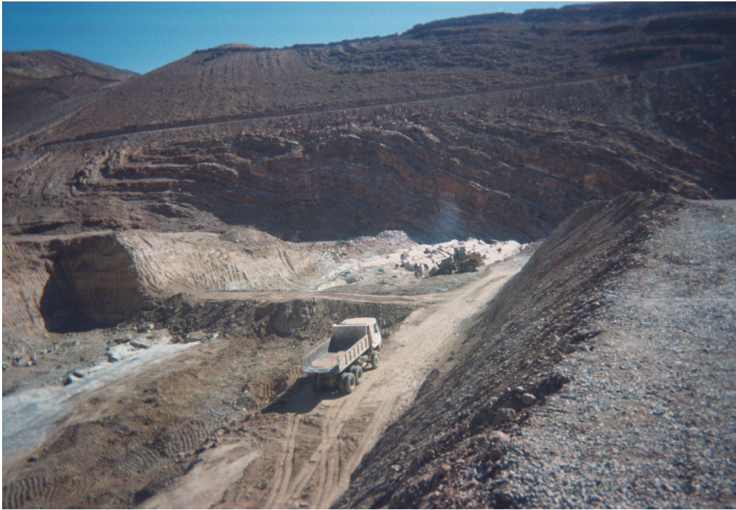
Photo illustrant le démarrage des excavations du barrage Sidi El Mahjoub dans la province de Guelmim
