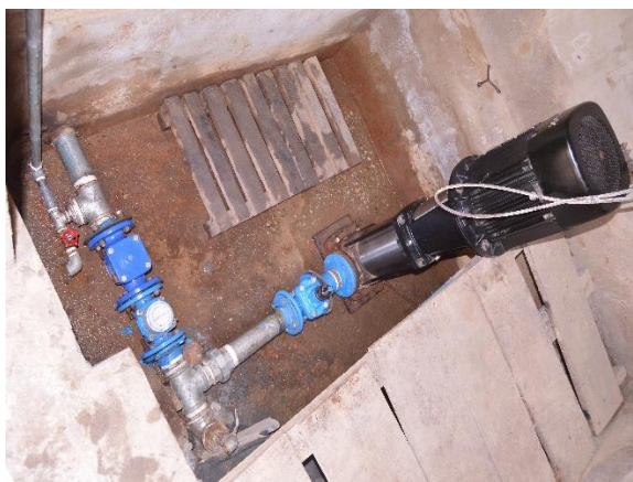
Salle de pompage de Kailo où les organes ont été renouvelés
