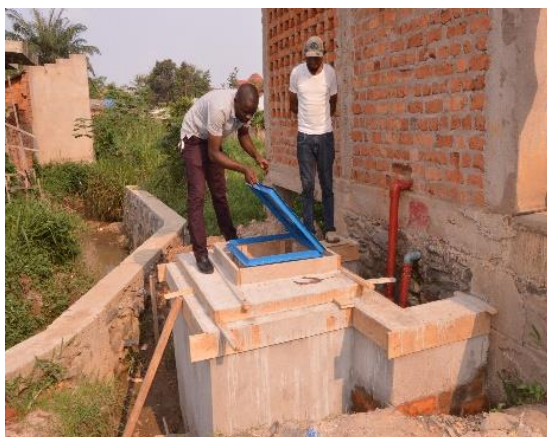
Construction de la chambre de compteur & vanne en amont BP/Hôtel Karibu, RVA/Kindu
