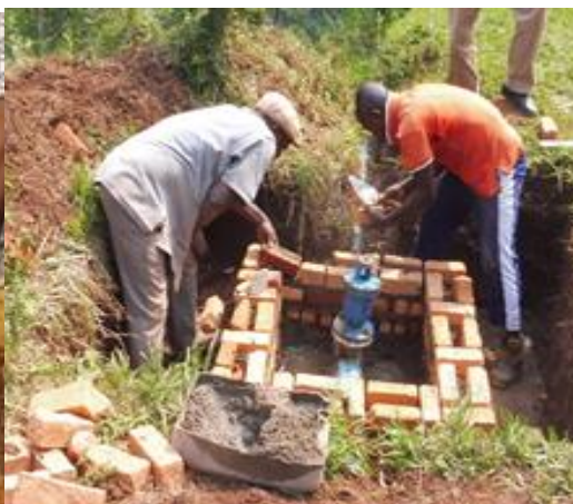
Installation des organes de régulation Cishado
