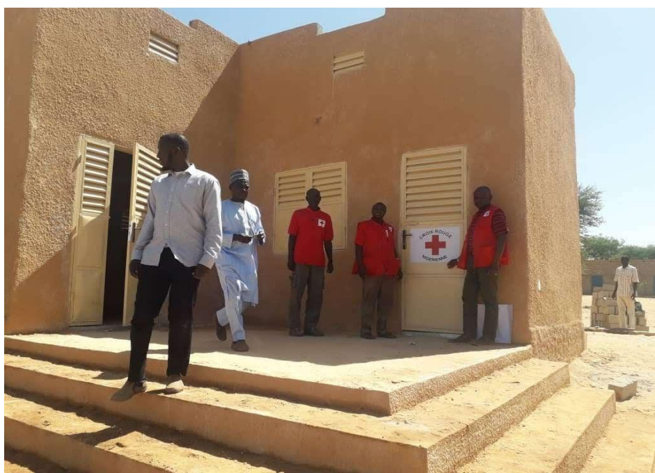
Siège Communal en construction (Bureau + Brigade + Magasin) de la commune de Guidiguir (Octobre 19)
