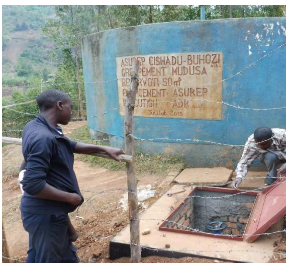
Réservoir 50 m 3 du réseau CISHADU
