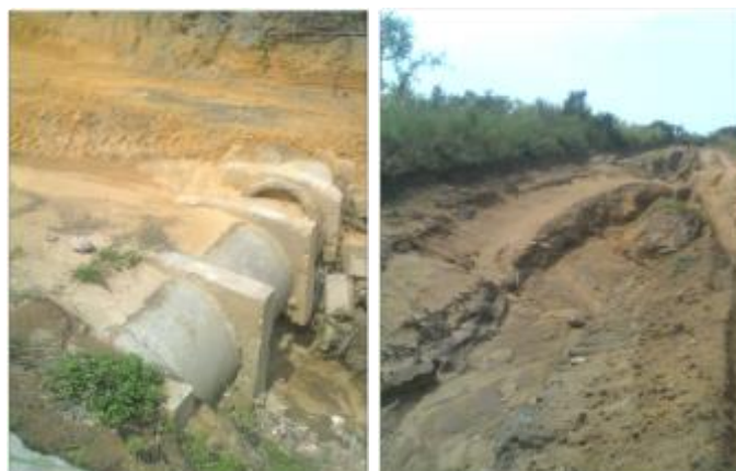
État de dégradation très avancé de l'axe Bukanga-Lonzo / Fatundu (2015)
