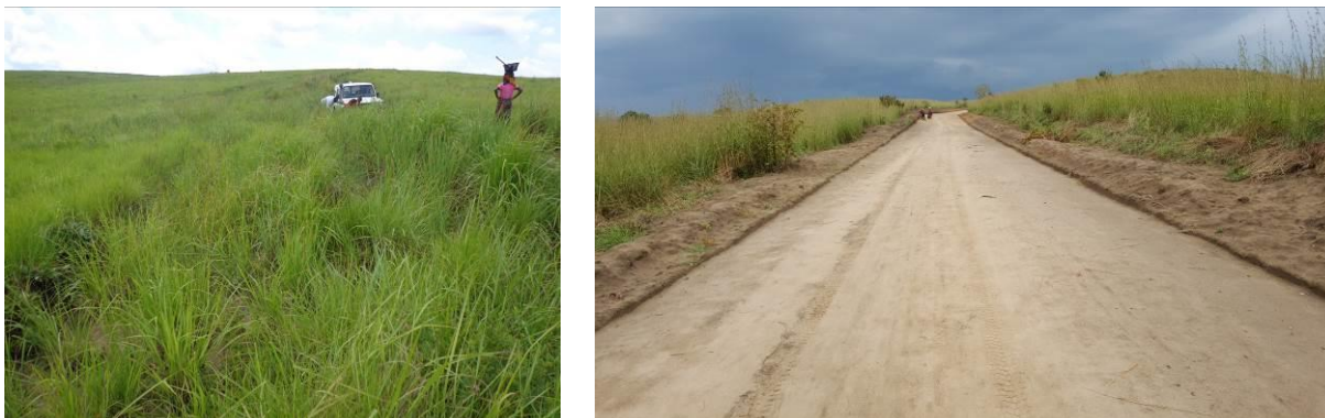
Travaux de réouverture de l'axe Village Mutselenge / Bac Kitona / Route de Feshi exécuté par des PME.
