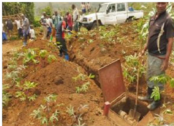
Travaux de réhabilitation de la remise en état du réseau de Mwendo
