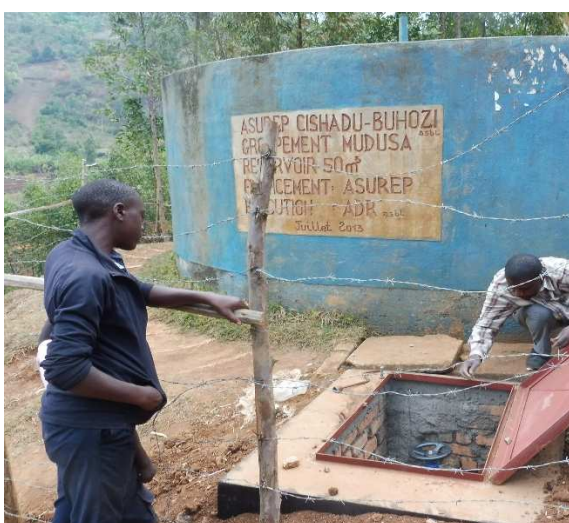
Réservoir 50 m 3 du réseau CISHADU
