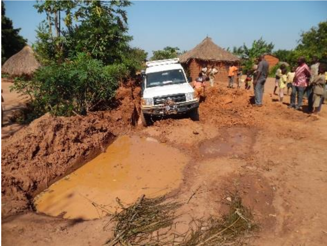
Etat de la route sur l'axe Kamiji
