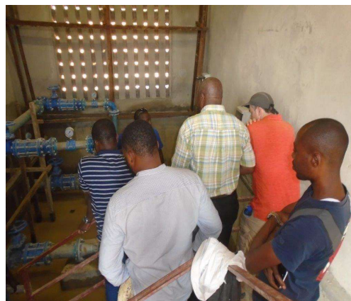
Salle de machines de la station de pompage de Basoko en plein essai hydraulique
