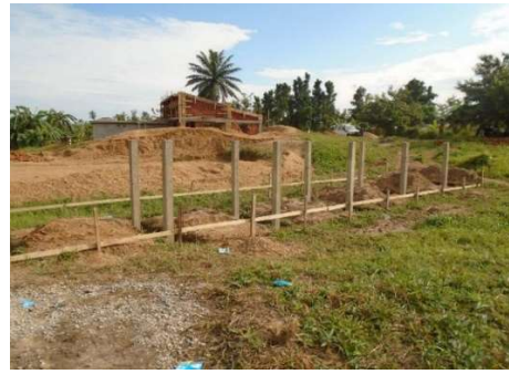
Exécution des socles en BA superstructure des panneaux solaires à Basoko, en arrière-plan la station de pompage
