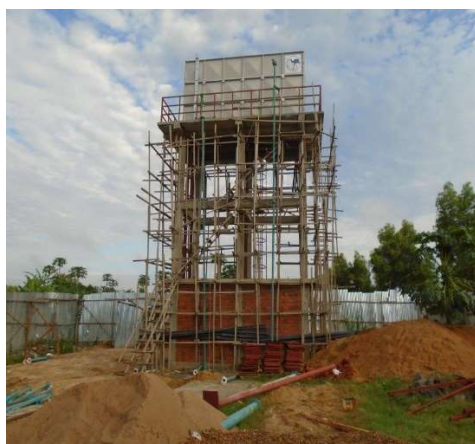
Château d'eau Kabasoga avec cuve monté
