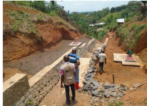
Captage Chute 1 et collecteur d'évacuation eau ruissellement
