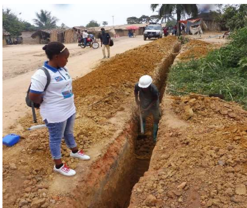
Femme Ir de Dematco conduisant les travaux de pose de canalisations au réseau de Kabasoga
