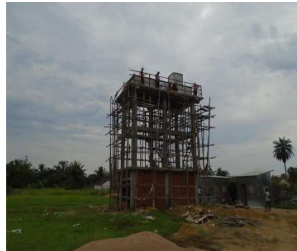
Château d'eau de Katakoto avec sa cuve de 18 m 3 montée
