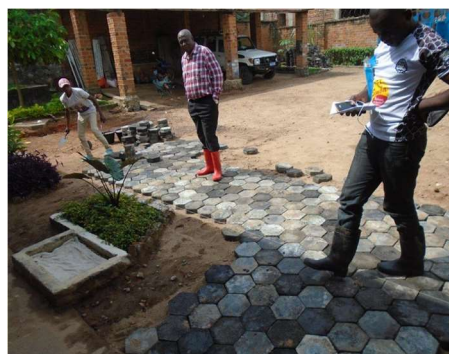
Planche d'essai des pavés au bureau Enabel (produits à l'aide de récupération des plastiques collectées lors du ramassage des ordures.)
