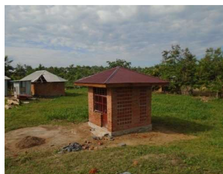
Local production de chlore en phase de finition à la station de pompage de Basoko
