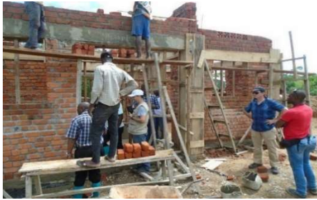
Salle de machines de Big five
