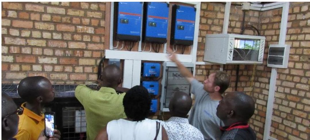
Photo : formation des techniciens référents au fonctionnement et à l'entretien maintenance des installations de back-up de l'énergie au CFP Karurama.
