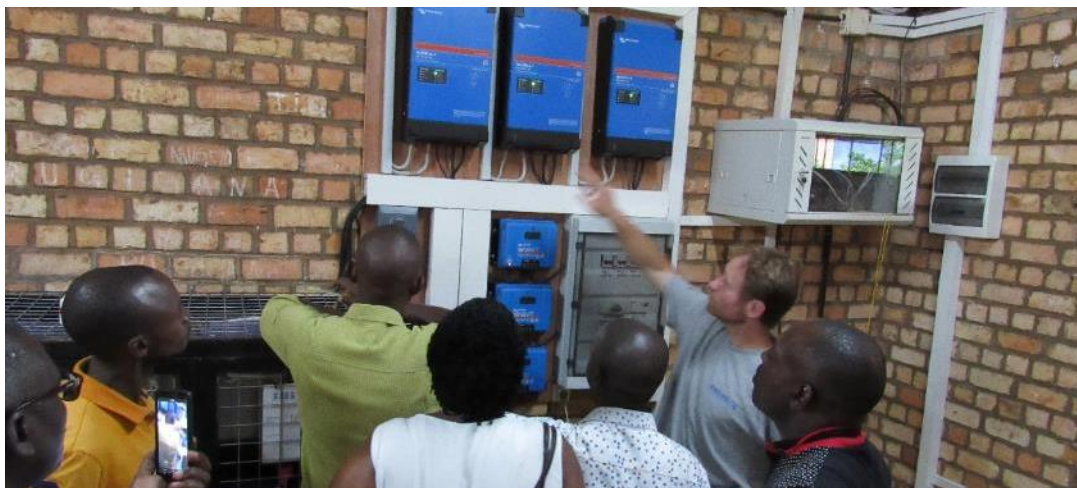
Photo no. 4 : formation des techniciens référents au fonctionnement et à l'entretien maintenance des installations de back-up de l'énergie au CFP Karurama.
