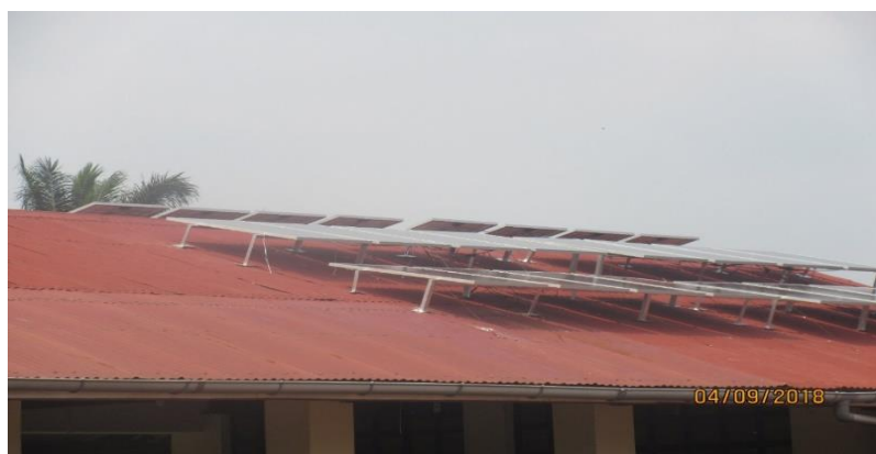
Photo 13 : Système d'énergie solaire installer par EDUKOR pour alimenter : bureaux, classes, laboratoires, poulailler, porcherie.
