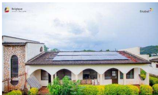
Panneaux photovoltaïques installés sur le bâtiment administratif – Commune de Kirundo – décembre 2025
